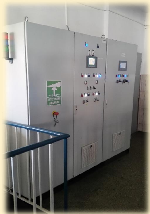
Układ sterowniczy pomp wody czystej i surowej.
