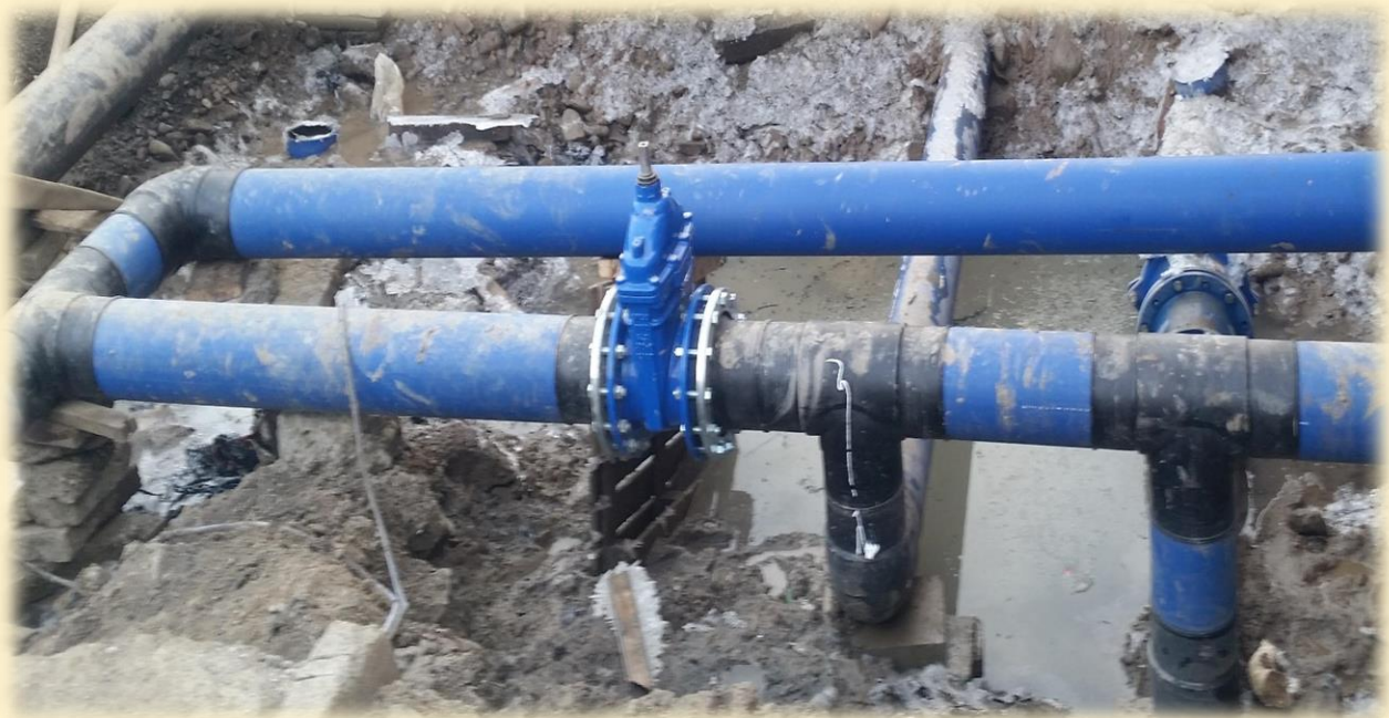
Rurociągi technologiczne z PE
